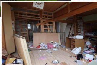
(右)上の建物の室内の様子。梁などが大きく損傷しているのが分かる。
