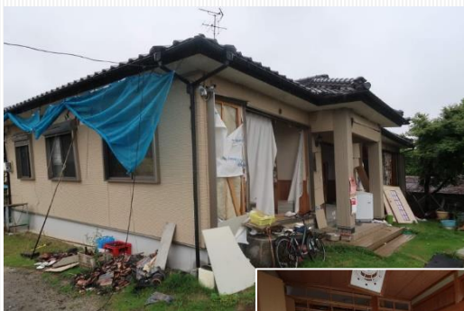
(上)平屋の建物が桁行方向に大きく傾いて全壊した。
